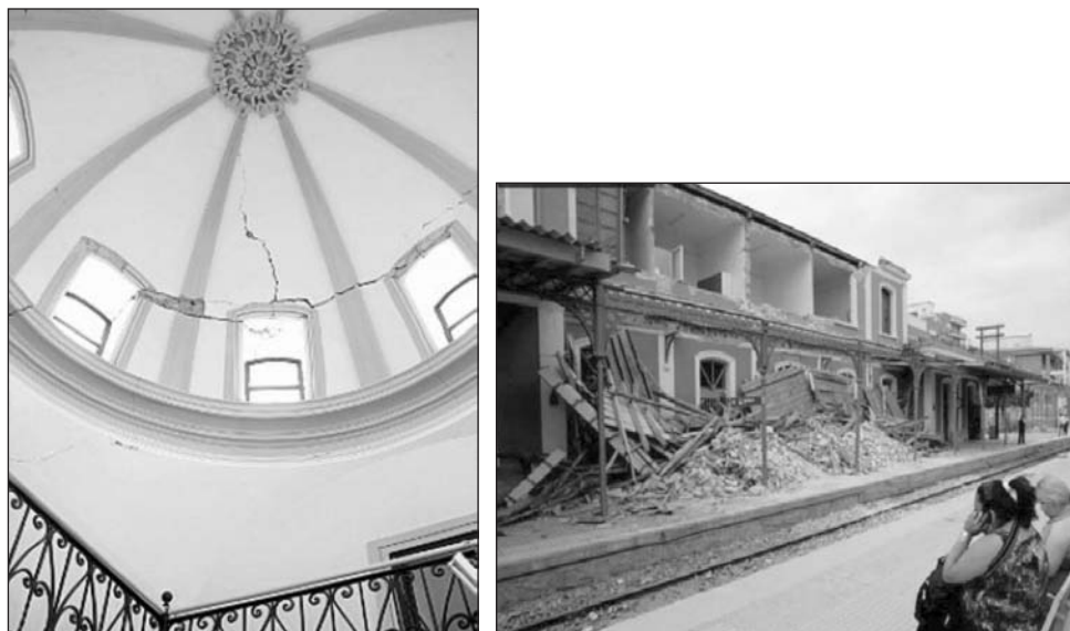
FIGURAS 16 y 17: A la izquierda, cúpula del Conservatorio, fracturada. A la derecha, derrumbe producido en la Estación, en la que el muro de fábrica de ladrillo perdió el equilibrio y cayó sobre la marquesina, rompiendo el entramado de viguetas.
